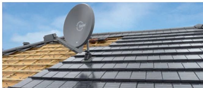
Schönes Dach, eigener Strom: Mit dem Autarq-Verfahren kann jede beliebige Dachziegelform mit Solarzellen bestückt werden.
